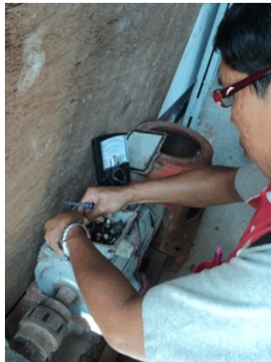
ภาพที่ 4 ตรวจสอบสภาพมอเตอร์
