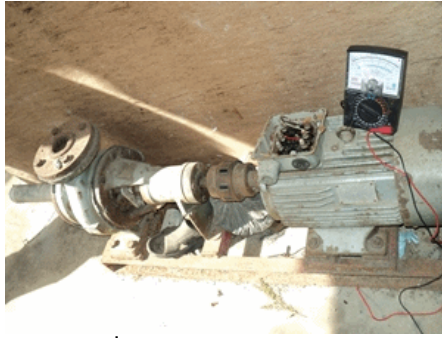
ภาพที่ 5 ตรวจสอบสภาพมอเตอร์
